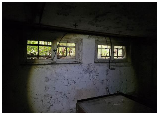
Abbildung 15: offene Fenster kurz oberhalb des anstehenden Geländes
