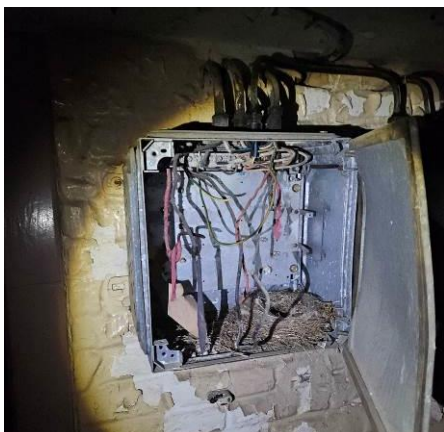
Abbildung 14: Hausrotschwanznest in Stromverteilerkasten
