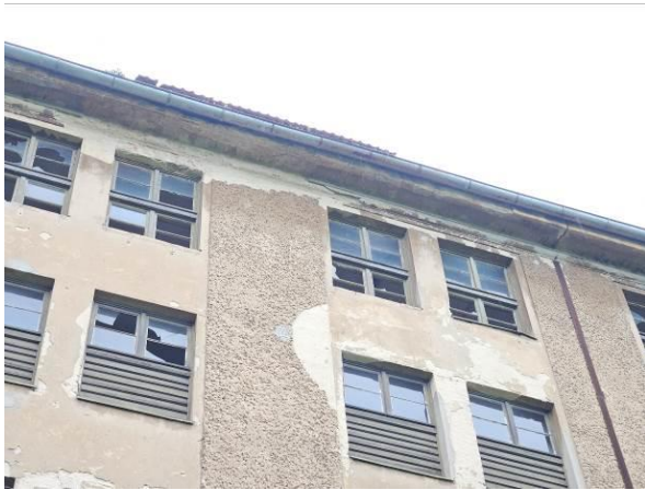
Abbildung 6: abplatzender Putz an der Nordfassade
