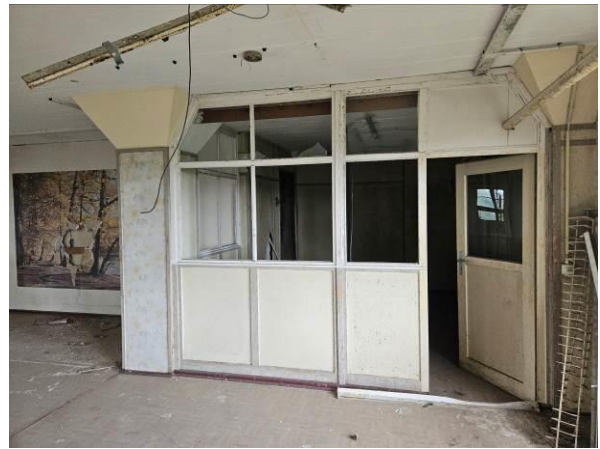
Abbildung 47: Raum südlich des östlichen Treppenhauses mit Fledermauskot
