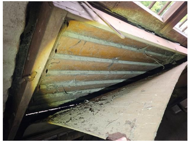
Abbildung 25: teilweise offene Lüftungsklappenverkleidung
