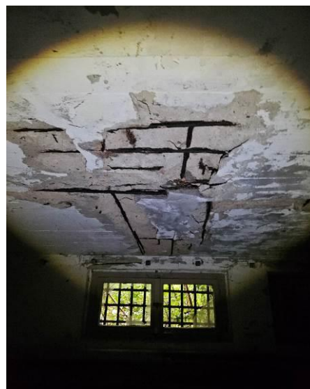
Abbildung 13: stellenweise abplatzender Beton an der Decke
