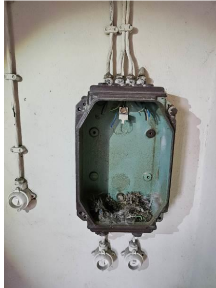
Abbildung 29: Hausrotschwanznest in Stromverteilerkasten
