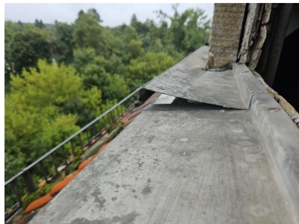
Abbildung 9: Fensterblech mit Spalt – potentielles Fledermausquartier
