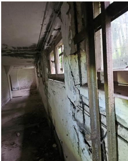
Abbildung 12: stellenweise abplatzender Beton an den Wänden
