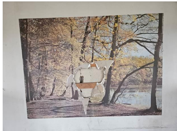
Abbildung 45: Wandverkleidung teilweise kaputt
