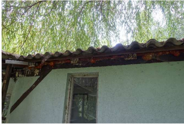
Abbildung 5: Spaltenstrukturen im Dachbereich
