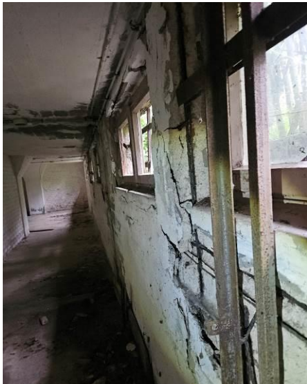
Abbildung 12: stellenweise abplatzender Beton an den Wänden
