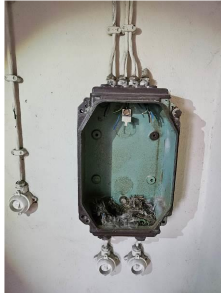
Abbildung 29: Hausrotschwanznest in Stromverteilerkasten
