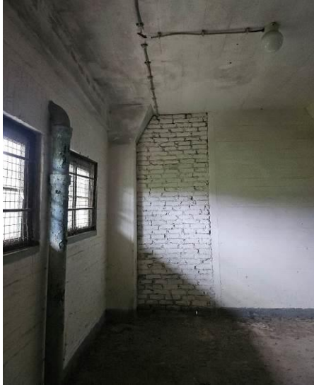
Abbildung 20: Ausmauerung mit offenen Fugen
