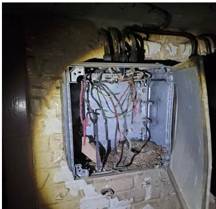
Abbildung 14: Hausrotschwanznest in Stromverteilerkasten
