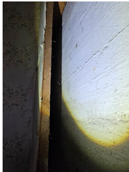
Abbildung 27: Spalt hinter Wandverkleidung
