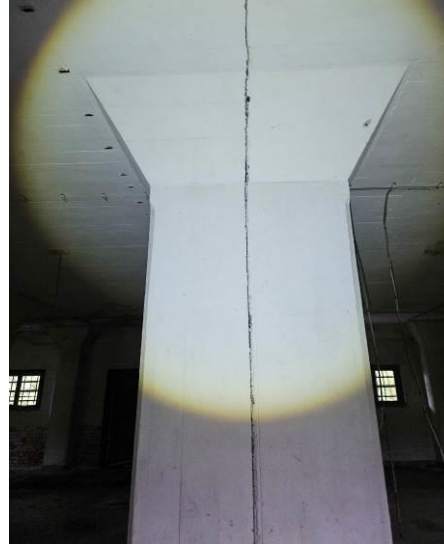
Abbildung 21: Dehnungsfuge in einer der Säulen
