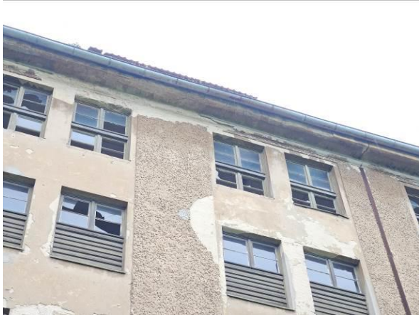
Abbildung 6: abplatzender Putz an der Nordfassade
