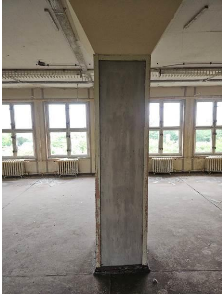
Abbildung 46: Verkleidete Säule mit Fledermauskot
