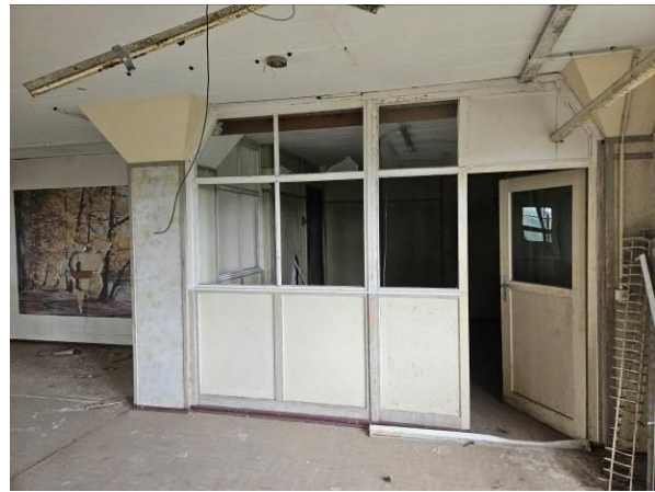
Abbildung 47: Raum südlich des östlichen Treppenhauses mit Fledermauskot
