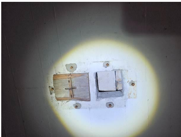
Abbildung 40: von oben verschlossenes Loch in Decke (Blick nach oben)
