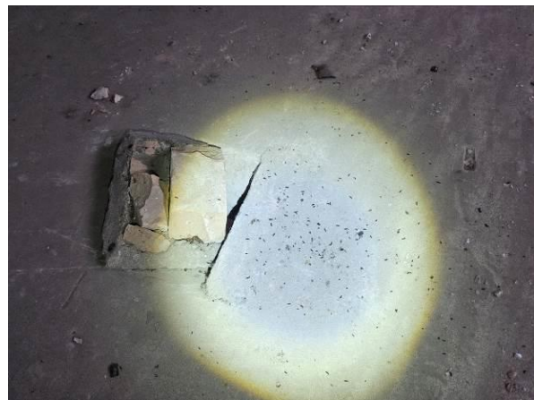
Abbildung 41: Fledermauskot unterhalb des Lochs in der Decke
