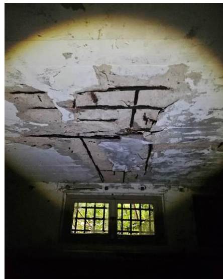
Abbildung 13: stellenweise abplatzender Beton an der Decke
