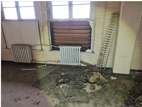
Abbildung 44: teilweise verschlossene Lüftungskappen unten den Fenstern
