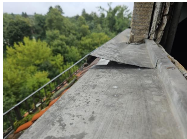
Abbildung 9: Fensterblech mit Spalt – potentielles Fledermausquartier
