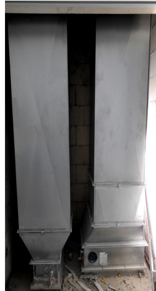
Be- und Entlüftung
